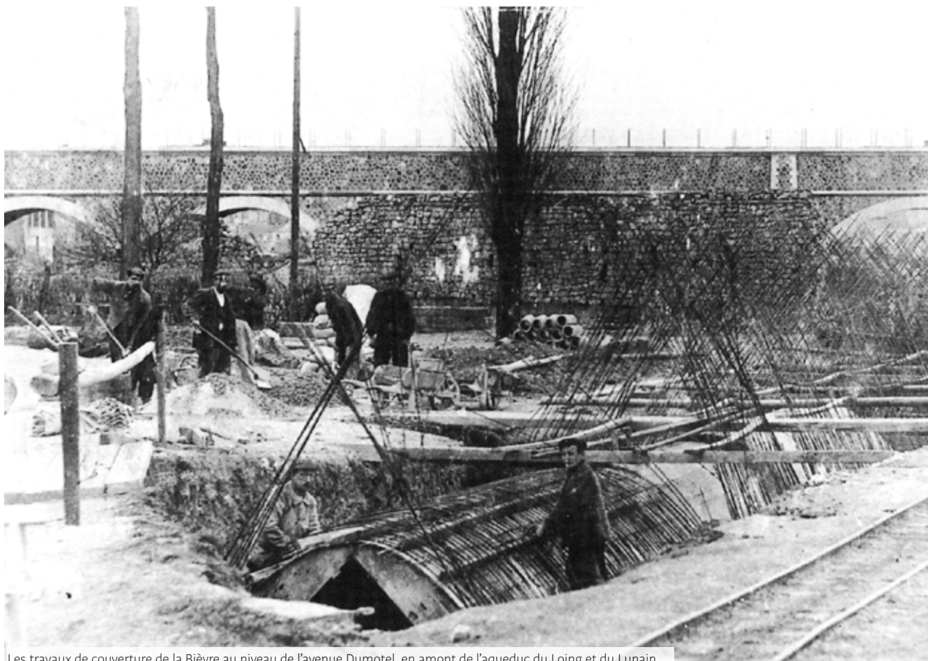
Les travaux de couverture de la Bièvre au niveau de l'avenue Dumotel, en amont de l'aqueduc du Loing et du Lunain.
