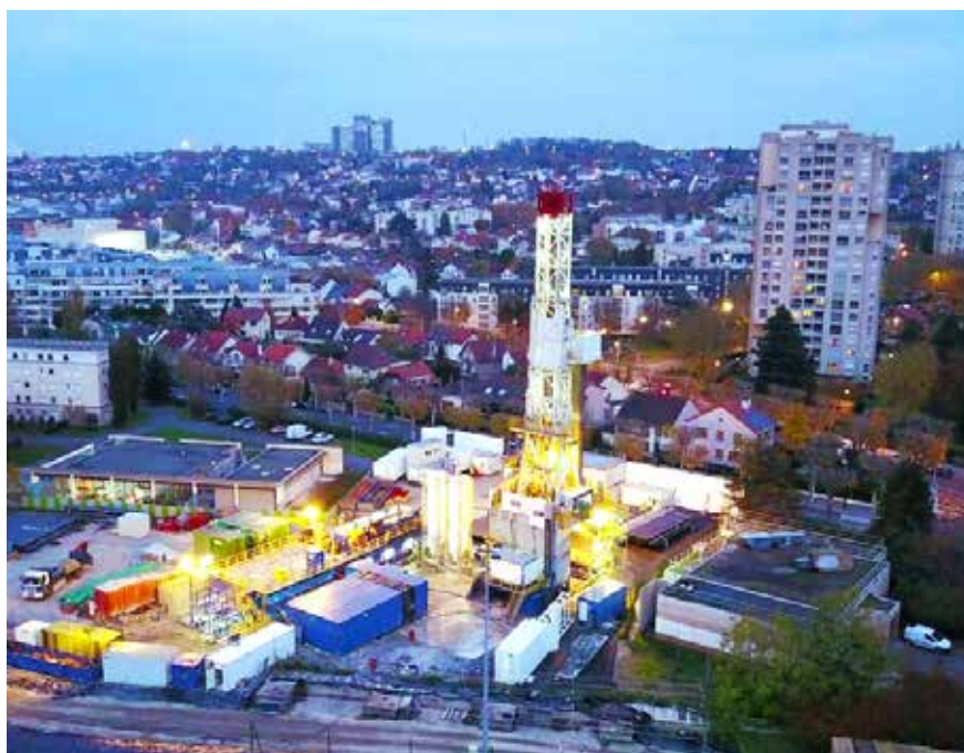
Pionnière en matière de géothermie, la Ville utilise ce système pour alimenter son réseau de chauffage urbain depuis 1984
